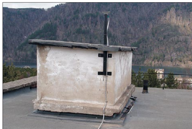
Рис. 1. Типовое закрепление антенны и монтаж оборудования пункта дифференциальной подсистемы Красноярского края [ http://globalsibir.com/article/a-19.html ]
